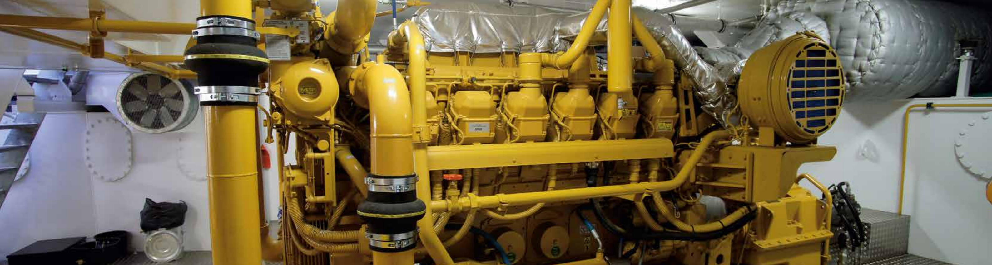
Maschinenraum der MS Delos
